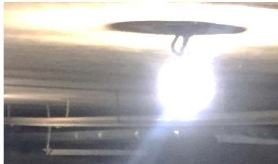
Наличие защитного колпака на светильнике в подвале
