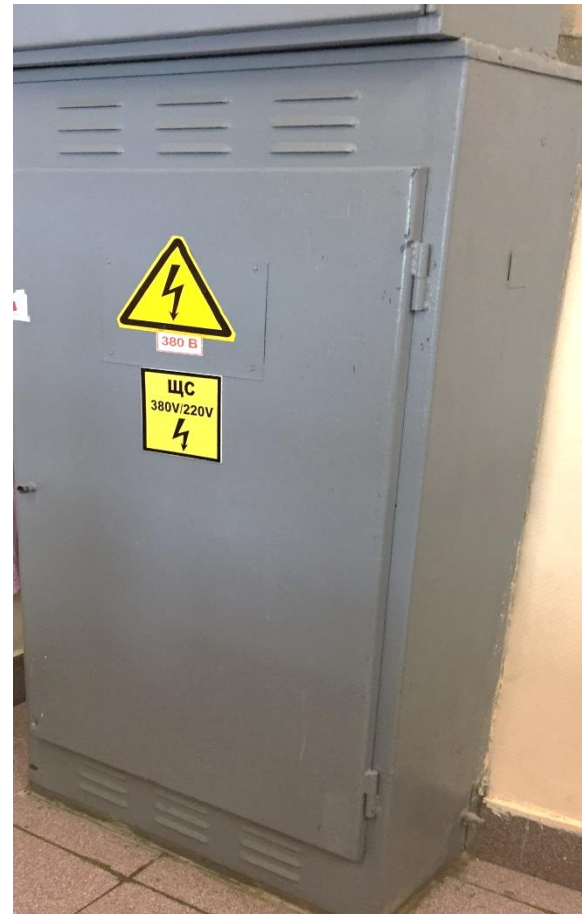
Наличие знаков электробезопасности на двери электрощита
